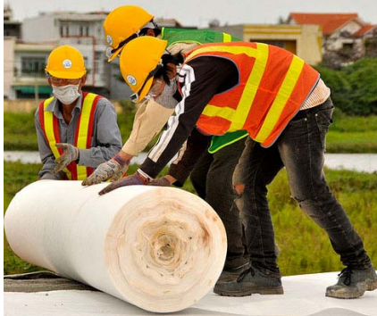
Các công nhân hoàn thành công tác chuẩn bị tại Sân bay Đà Nẵng.
