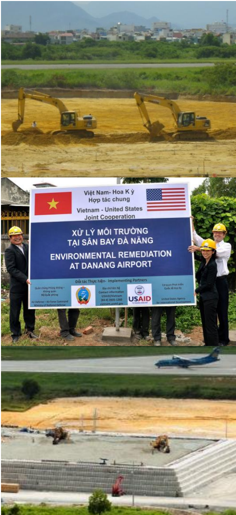
Các nhà thầu của USAID thực hiện đào xúc đất nhiễm bản dioxin và đưa vào kết cấu móng tại Sân bay Đà Nẵng
